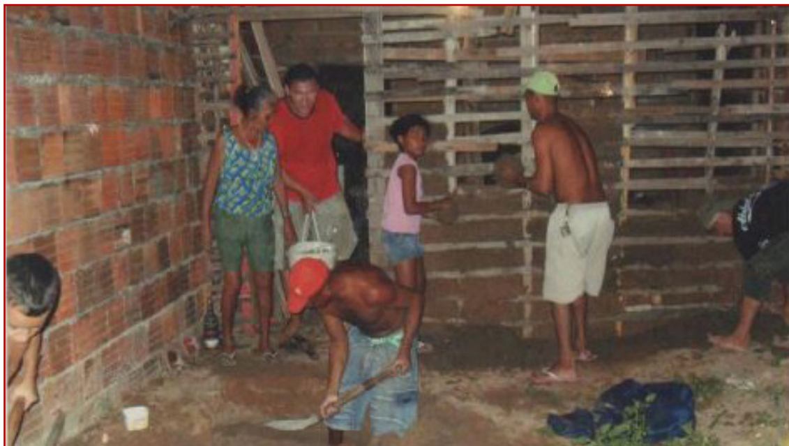
Imagem 02: Moradores construindo sua moradia na comunidade Rosalina. Fonte: Arquivo particular da Associação Comunitária da Rosalina, s/d.
